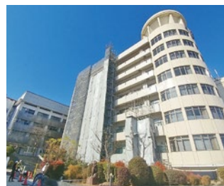
防護シートが一部はがされました(2023年12月撮影)
